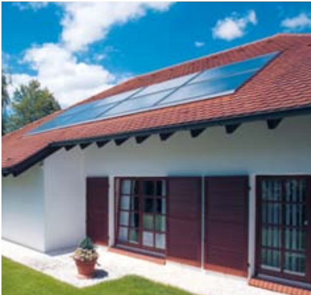
Acht horizontal angeordnete Indachkollektoren für die Trinkwassererwärmung und Heizungsunterstützung
