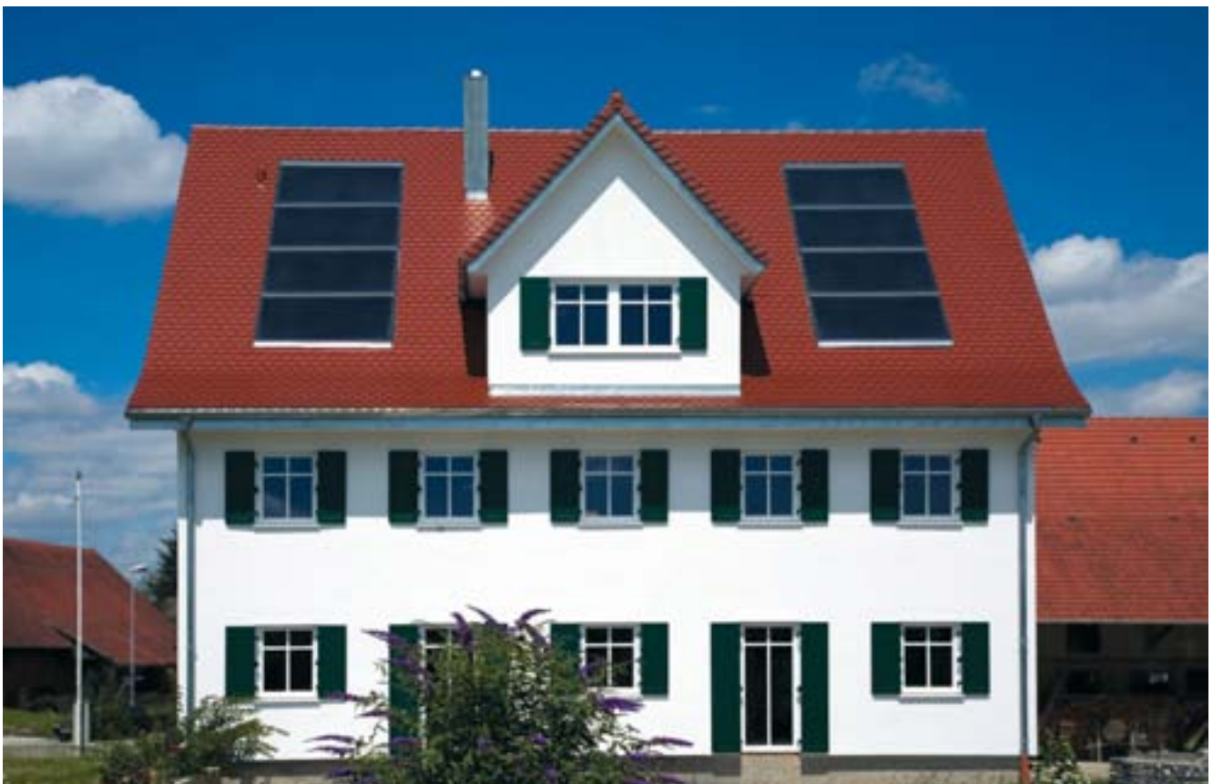
Zweimal vier Indachkollektoren vertikal zur Trinkwassererwärmung mit Heizungsunterstützung
