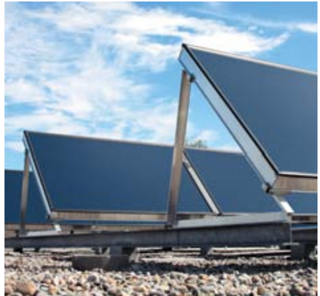
Anlage mit Flachdachkollektoren für den grossen Wärmebedarf
